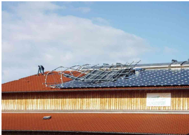
Obrázek 12: Poškození systému silným větrem v důsledku nesprávného dimenzování systému upevnění
