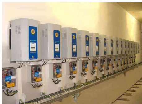
Obrázek 4: Servisní místnost pro systém o výkonu 52 kWp
