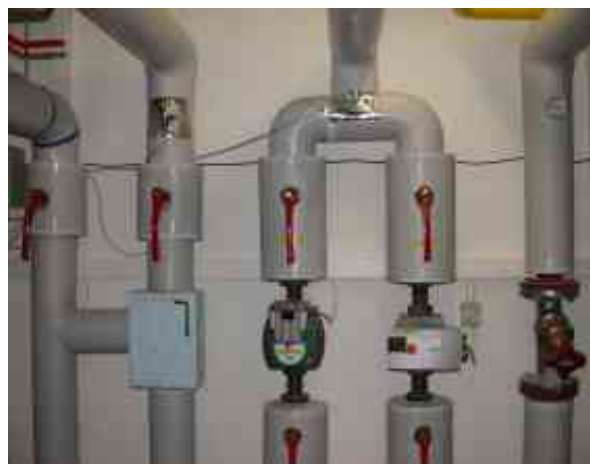
Obr. 7.5: Izolace armatury jako standard moderních zařízení zásobujících teplem.
