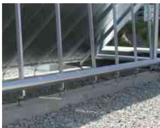
Obr. 7.3: Povrch kaučukových pouzder trubek je trvale chráněn plechovým pláštěm před UV-zářením a poškozením způsobeným zvířaty.
