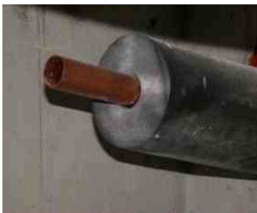
Obr.7.2: Volně položené potrubí v solárních systémech by mělo být izolováno teplotně stálými a vodě rezistentními kaučukovými pouzdry.
