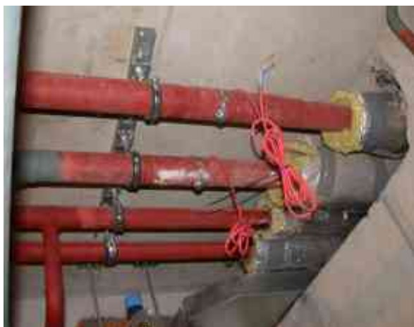
Obr. 7.4: Žádné redukování nebo dokonce vynechání izolace trubek při průrazu stěny nebo stropu.
