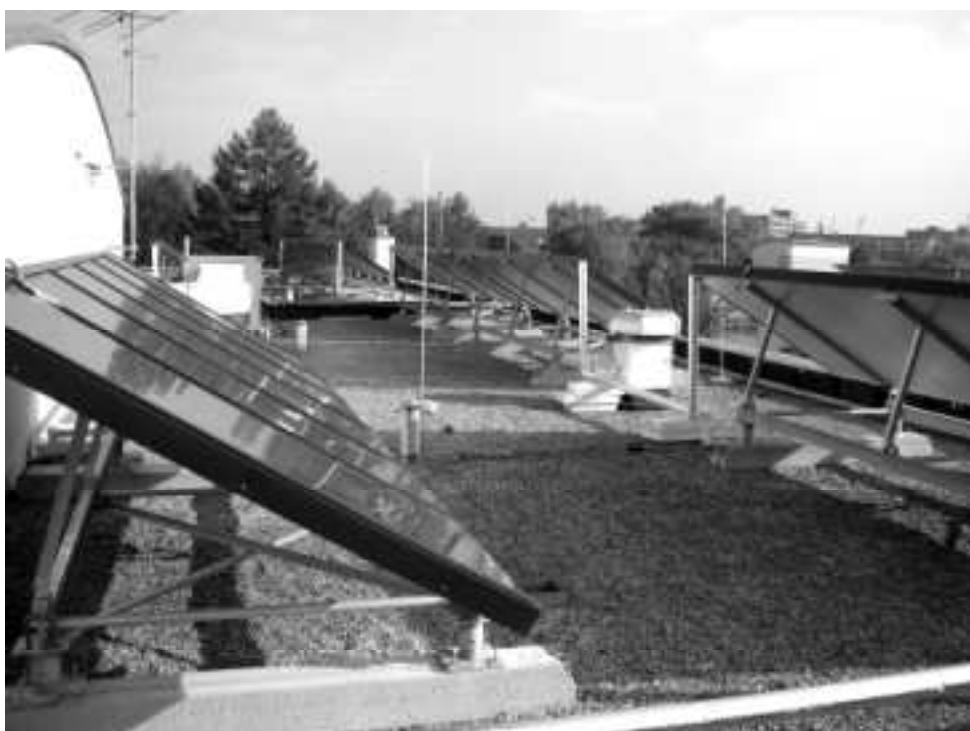
Celkový pohled na 2. sekci velkoplošných kolektorů zezadu
