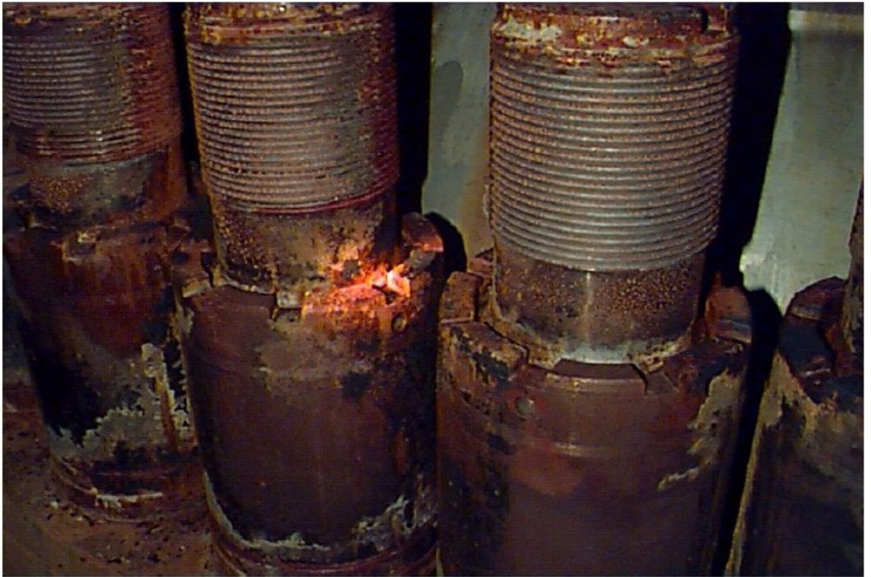
JETE - Detailní pohled na zkorodované svorníky
