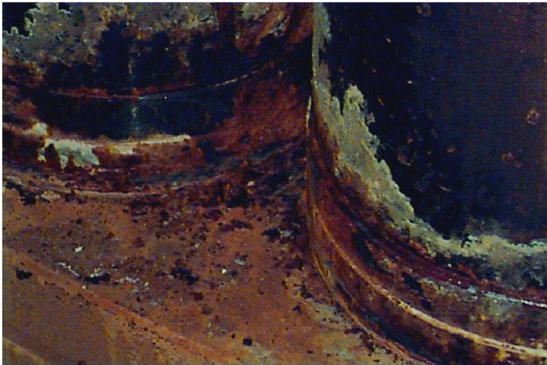
Detailnější pohled na korozi svorníků
